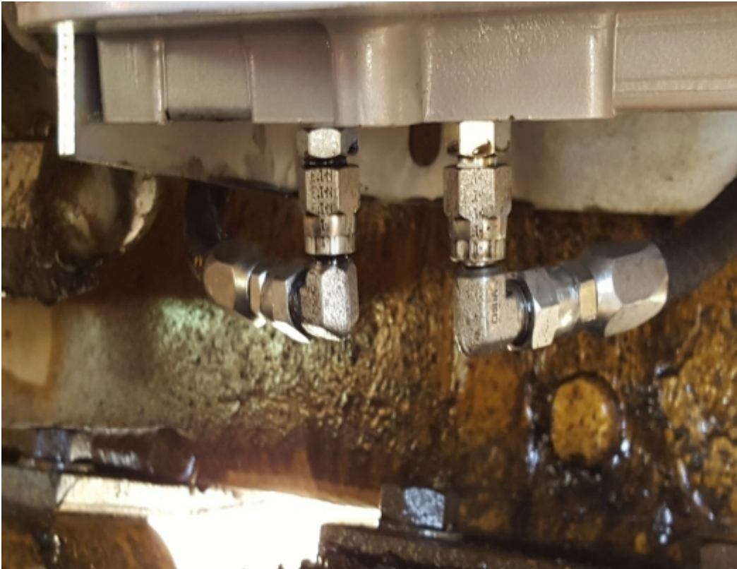
MANGUERAS DE INGRESO Y SALIDA DEL SISTEMA KLEENOIL
